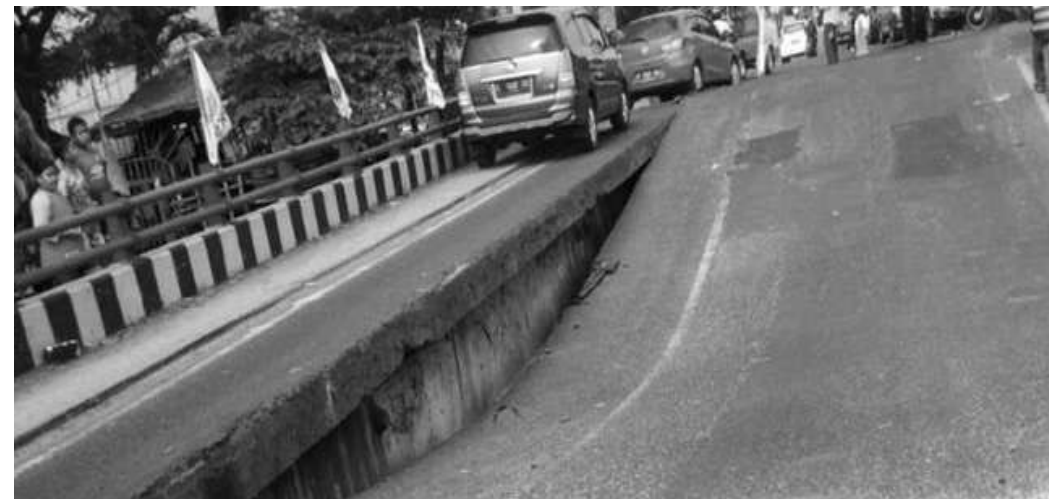
Kondisi Jembatan Balun Lamongan yang ambles
