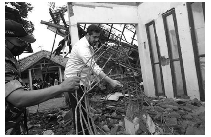
Wali Kota Hadi Zainal Abidin Meninjau langsung keadaan Aula Kelurahan yang Ambruk.
