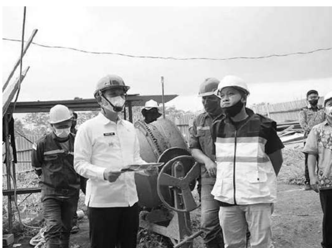
Bupati Lumajang Thoriqul Haq memantau langsung progres pembangunan Gedung Universitas Negeri Jember Kampus Lumajang di Desa Kebonan Kecamatan Klakah,
